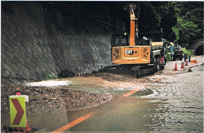
国道389号線通行止め
